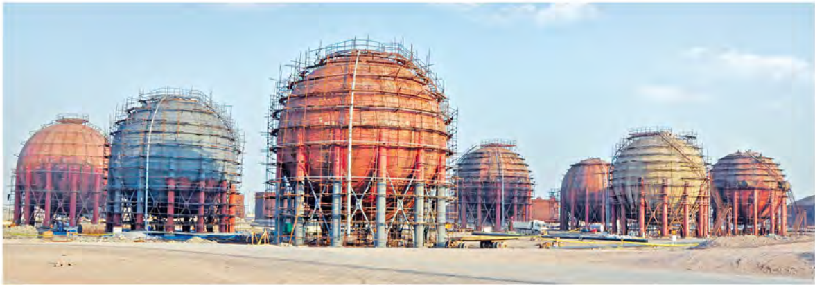
مخازن کروی پالایشگاه ستاره خلیج فارس در مراحل میانی ساخت Persian Gulf Star Oil Refinery spherical tanks at the middle of project
